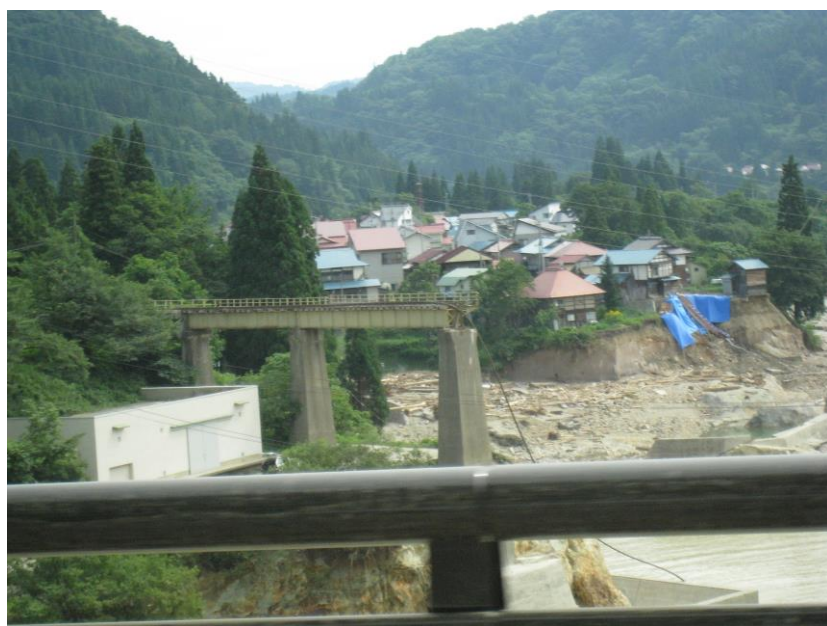
豪雨により流失した JR 只見線の鉄橋
